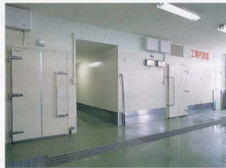
■大型冷凍冷蔵庫設備
